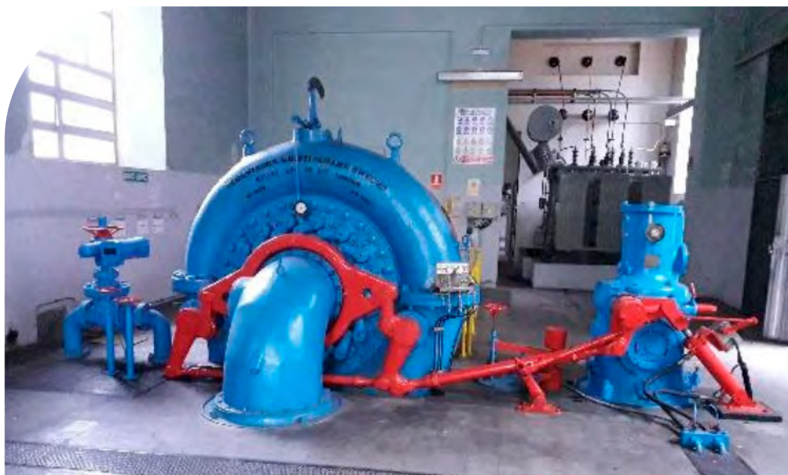
Turbina de la central de Castillonroy
