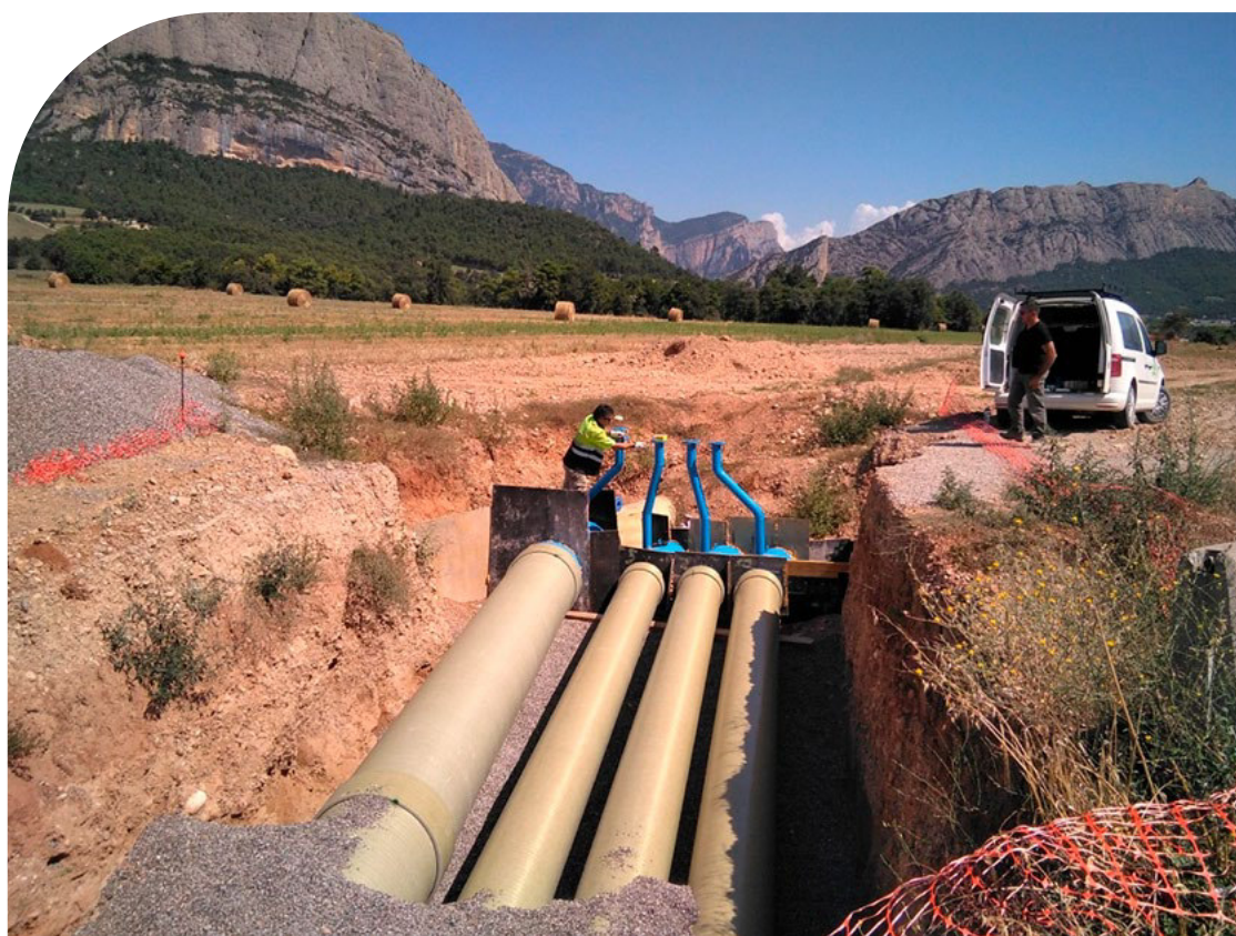
Tuberías de distribución
