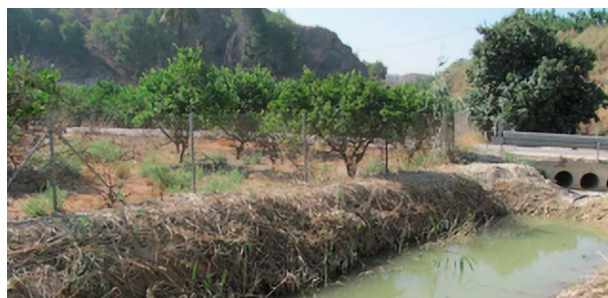
Estado de la zona tras la inundación
