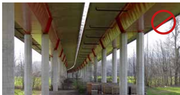
Figura 5.9. Uso inadecuado de los terrenos situados bajo el viaducto. Foto: C. Rosell.
