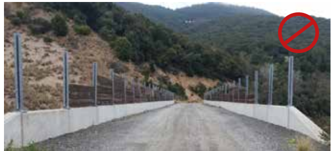
Figura 13.9. Para dificultar el robo de las placas de madera es recomendable que las pantallas cuenten con la protección de una barra metálica en su parte superior que evite la extracción de los tablones. Foto: Minuartia.
