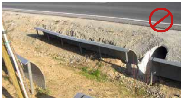
Figura 11.12. Discontinuidad entre distintos tramos del vallado de guía. Foto: F. Navàs.
