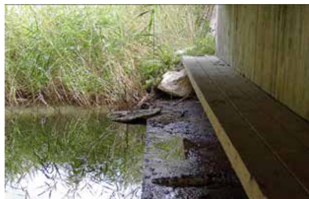
Figura 13.6. Drenaje adaptado para el paso de la fauna mediante la instalación de pasarelas secas laterales. A las banquetas de hormigón iniciales, se les añadieron plataformas de madera que se mantuvieron secas durante períodos más largos. Foto: Minuartia.
