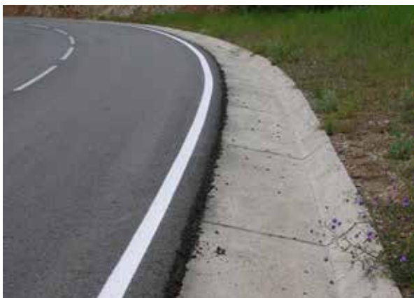
Figura 25.2. Cuneta que permite un fácil acceso a los márgenes de la vía de los animales que hayan cruzado la calzada. Foto: F. Navàs.
