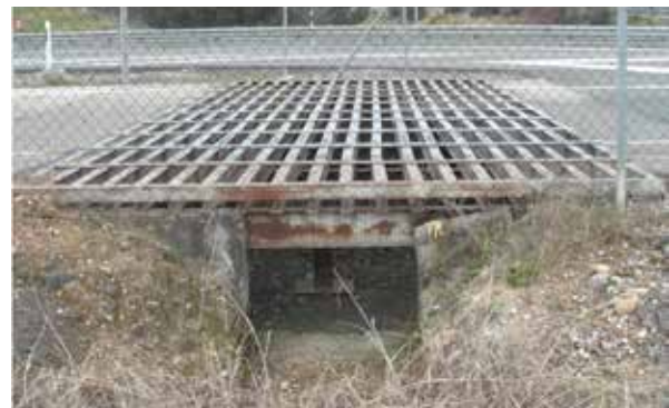
Figura 17.3. Paso canadiense con aperturas laterales que permiten la salida de los pequeños animales que puedan caer en su interior y facilitan el mantenimiento. Foto: Ministerio de Fomento.
