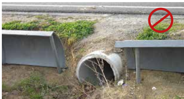
Figura 11.11. Desajuste entre la estructura de guía y el acceso al paso para anfibios. Foto: C. Rosell.
