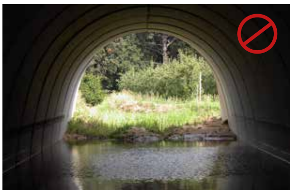
Figura 6.8. La inundación completa de la base de la estructura dificulta el paso de la fauna. Foto: C. Rosell.
