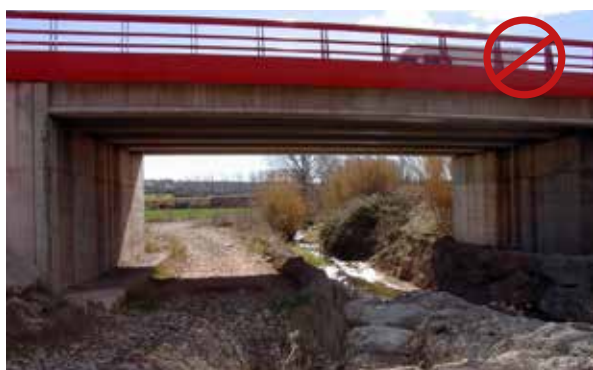
Figura 7.7. Escollera que dificulta el paso de fauna en la base y márgenes de la estructura. Foto: F. Navàs.
