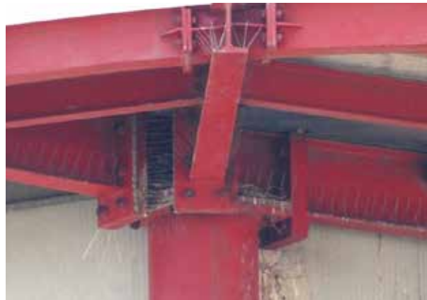
Figura 23.10. Púas para evitar que las aves se posen bajo un viaducto. Foto: F. Navàs.
