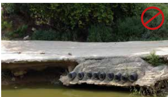
Figura 5.7. Camino de obra que ha interrumpido la continuidad del curso fluvial. Foto: R. Campeny.
