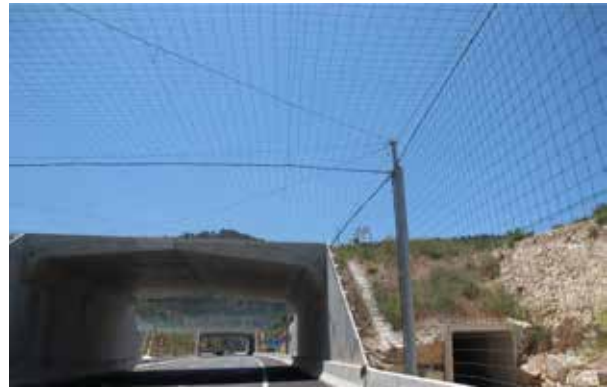
Figura 15.7. Estructura de red de poliamida constituyendo una cobertura en túnel para prevenir la colisión de murciélagos en una carretera. Foto: M. Fernández Bou.
