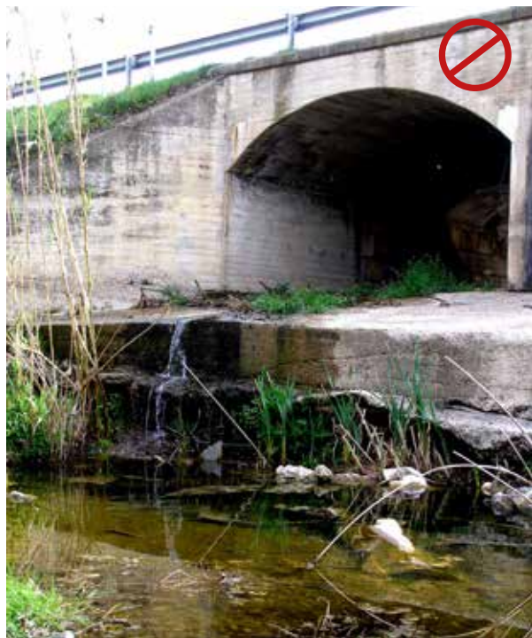
Figura 10.6. Socavación de la base de la estructura que ha generado un desnivel insalvable para la fauna acuática. Foto: M. Clavero.
