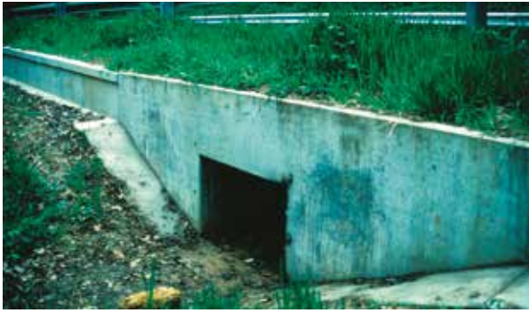
Figura 11.5. Paso de anfibios y estructura de guía constituido por un murete de hormigón. Foto: J. Niederstrasser.
