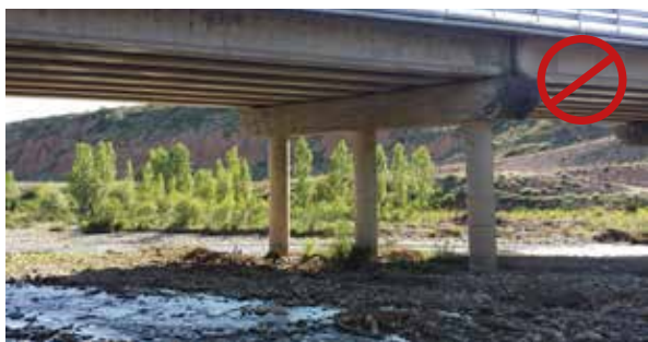
Figura 5.8. Mala disposición de las pilas en el interior del cauce. Foto: F. Navàs.
