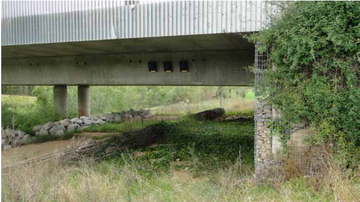
Figura 26.7. Diversos tipos de refugios instalados en un viaducto adaptado para fomentar su uso por parte de la fauna. Pueden apreciarse refugios para murciélagos en el tablero del viaducto, así como hileras de piedras y de madera muerta en el suelo fomentando la presencia de una amplia comunidad faunística. Foto: Minuartia.
