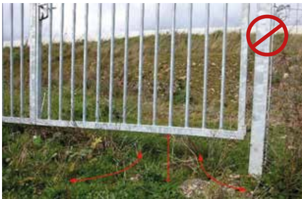
Figura 17.10. Las puertas no deben dejar huecos en la parte inferior que permitan a los animales acceder a la calzada. Foto: Cerema ('IENE Biodiversity and Infrastructure Handbook').
