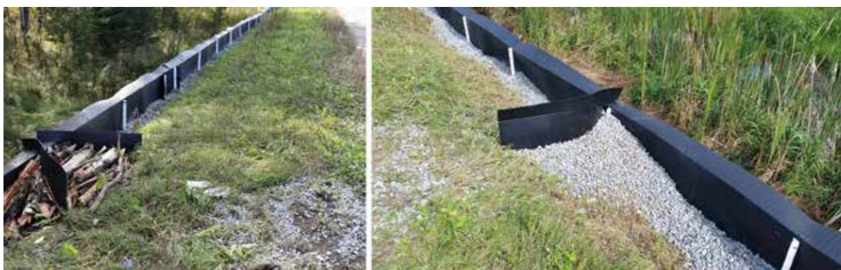
Figura 16.5. Rampas para anfibios y reptiles instaladas en la parte interior de un vallado de guía de un paso para anfibios. Fotos: Animex Internacional ('IENE Biodiversity and Infrastructure Handbook').
