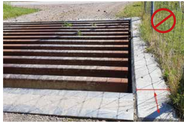
Figura 17.9. No deben quedar espacios que permitan el paso de los animales entre el cerramiento y el paso canadiense. Foto: C. Rosell ('IENE Biodiversity and Infrastructure Handbook').
