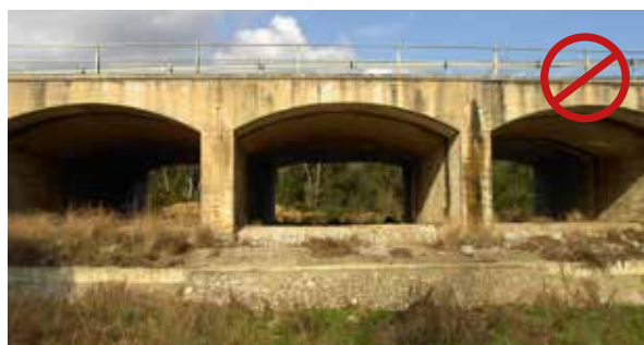
Figura 5.11. Puente con la superficie hormigonada bajo su luz, que impide la continuidad de la vegetación de ribera. Foto: Minuartia.
