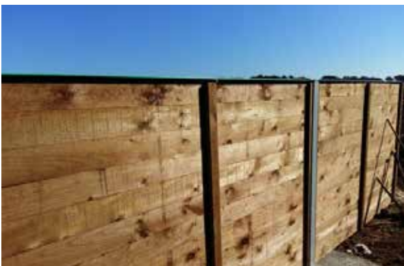
Figura 13.5. Pantalla instalada para reducir las perturbaciones generadas por el tráfico en un paso superior multifuncional, que cuenta con una protección metálica que reduce el riesgo de robo de las placas de madera. Fotos: Minuartia.
