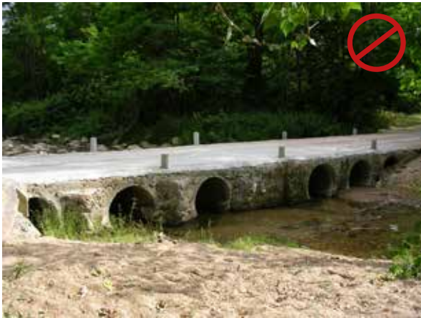
Figura 10.3. Drenajes situados en un badén que dificultan el paso de peces. Foto: F. Navàs.
