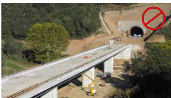
Figura 5.6. Destrucción completa de los hábitats del cauce durante la fase de construcción. Foto: C. Rosell.
