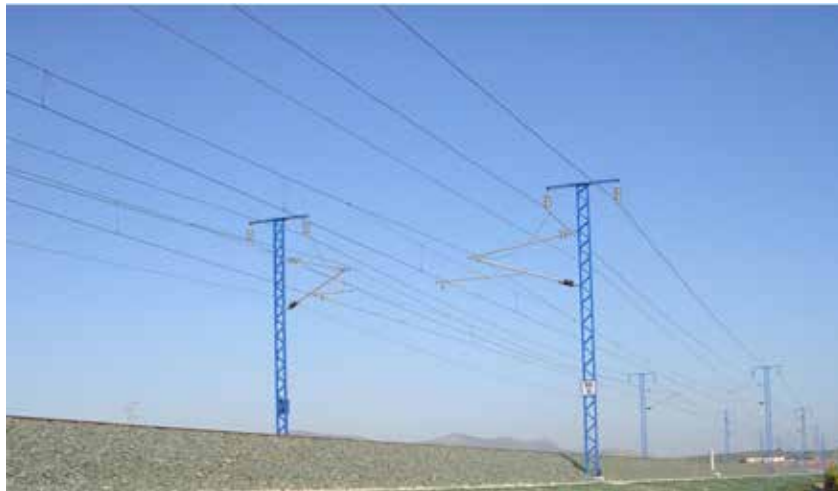
Figura 23.1. En algunos tramos de líneas de ferrocarril puede producirse mortalidad de aves por colisión con la catenaria y otros cables asociados al sistema de electrificación de la infraestructura. Este riesgo suele ser mayor en tramos que discurren en terraplén. Foto: F. Navàs.
