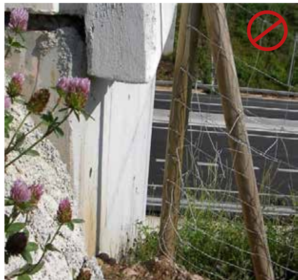
Figura 14.17. Ajuste deficiente entre la valla y la aleta del paso. Foto: F. Navàs.
