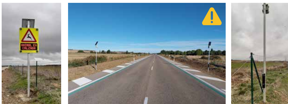
Figura 19.4. Paso de fauna a nivel. El vallado perimetral cuenta con una apertura equipada con sensores de fauna que activan las señales de advertencia. El desbroce de los márgenes contribuye a mejorar la visibilidad y evitar la activación de los sensores a causa de la vegetación y la señalización horizontal pretende crear un efecto de estrechamiento que contribuya a fomentar la reducción de velocidad. Fotos: Consejería de Movilidad y Transformación Digital de la Junta de Castilla y León.
