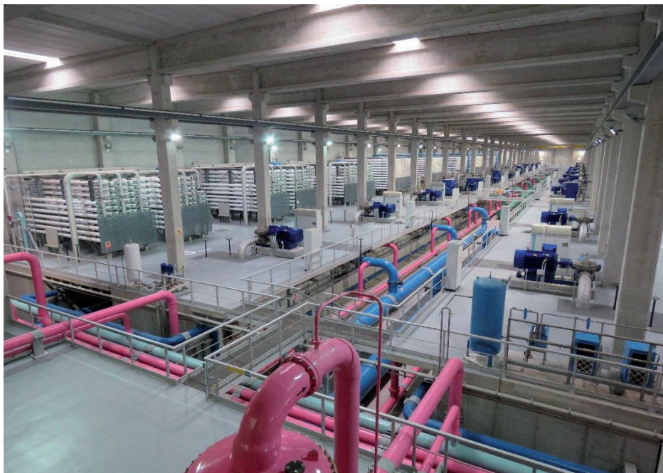
Figura 1.6. Instalaciones de la desaladora de Águilas-Guadalentín. Foto: M. B. Bernabé-Crespo.
