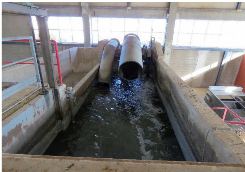
Figura 5.2. Entrada de agua bruta en EDAR Mar Menor Sur. Foto: M. B. Bernabé-Crespo.
