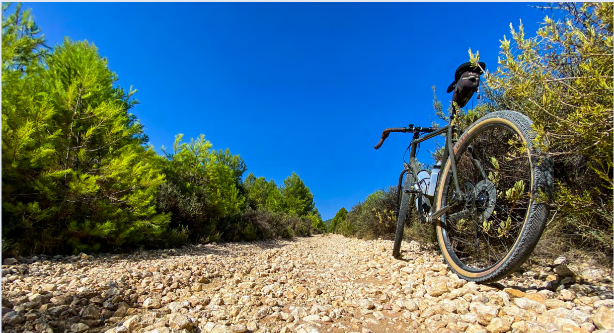
Detalle del pavimento en el camino de servicio con la grava suelta y la arena arrastrada por las lluvias.
