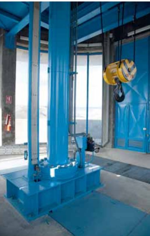
Equipos hidromecánicos en la torre de compuertas
