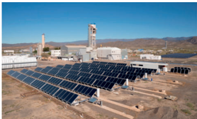
Campo Solar con captadores LBM de Wagner Solar. (Antes de la repotenciación)
