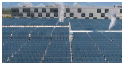
Figura 47: Datos característicos de las plantas de instalaciones solares térmicas de mayor tamaño
