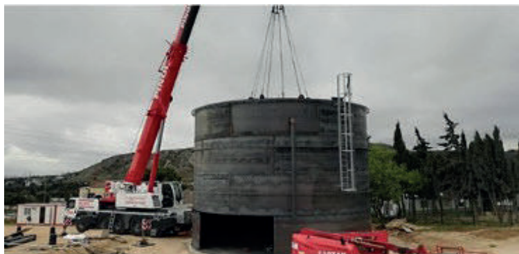
Instalación del tanque de almacenamiento de calor (© Newheat)
