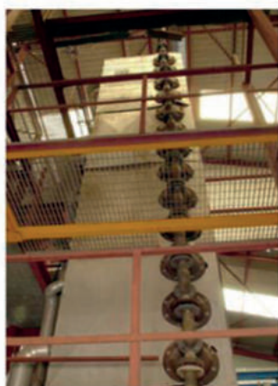
Planta de desalación MED Sol 14 en la Plataforma Solar de Almería
