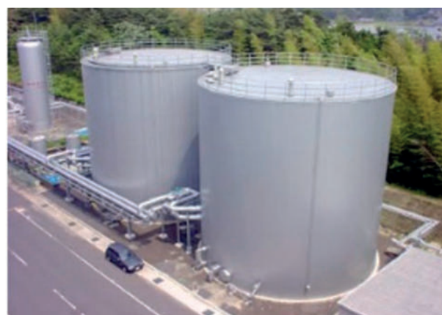
Almacenamiento de calor en tanques (© Newheat)
