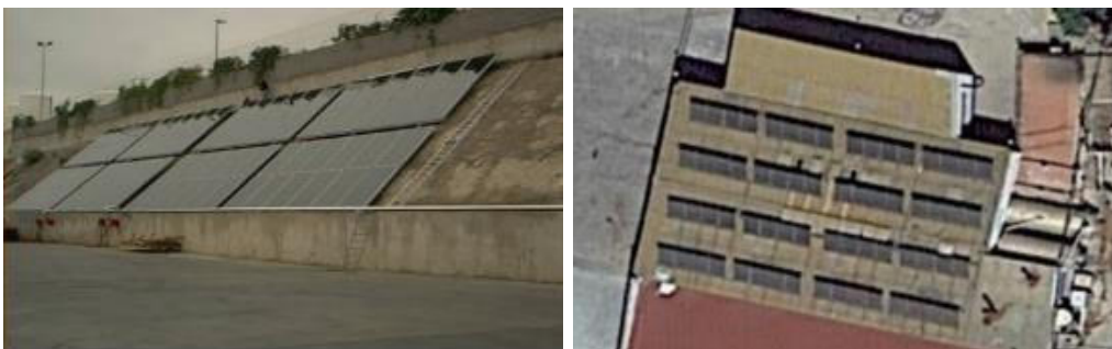
Figura 51: Instalaciones para lavado de cisternas
