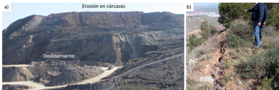
Figura 10. Riesgos geotécnico-estructurales en las escombreras de estériles mineros, a) deslizamiento y erosión en cárcavas en las escombreras Los Blancos, b) grietas de tracción en la cabecera del talud de la escombrera bajo los aerogeneradores SMCLU, parte alta de la cuenca que limita con la presa el Descargador I.
