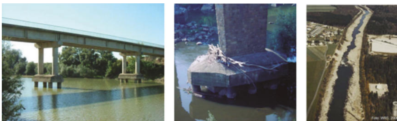
Figura 2.1. Erosión excesiva del lecho del río (a) y (b) que socava las estructuras; y (c) que incide en el lecho del río y provoca su ruptura (fuentes: (a) Fernando Magdaleno Mas; (b) Hervé Piegay; (c) Habersack & Piegay, 2007).
