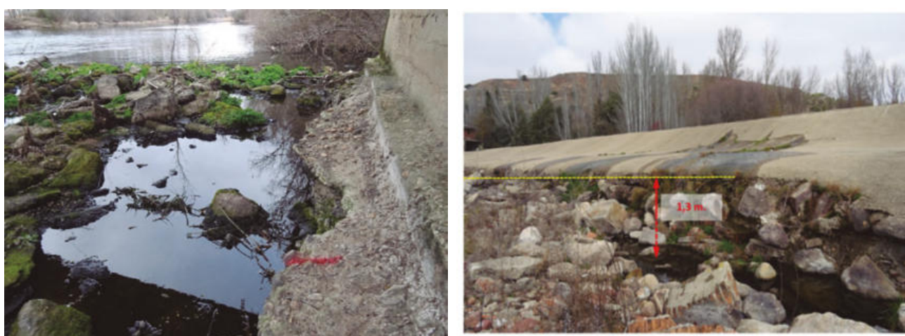
Figura A.4.4.2 Fenómenos de erosión local en dos puntos del tramo medio del río Tormes. (a) Base del pilar derecho del puente viejo de Encinas de abajo y (b) Azud de la Flecha.
