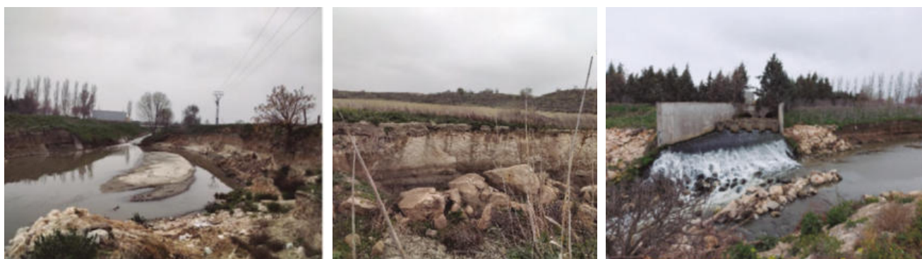
Figura A.4.10.2 (a) Fenómenos de erosión activa del cauce, (b) pérdida de sedimento y colapso de taludes y (c) descalse de infraestructuras, salida de la EDAR Arroyo Culebro Cuenca Baja.
