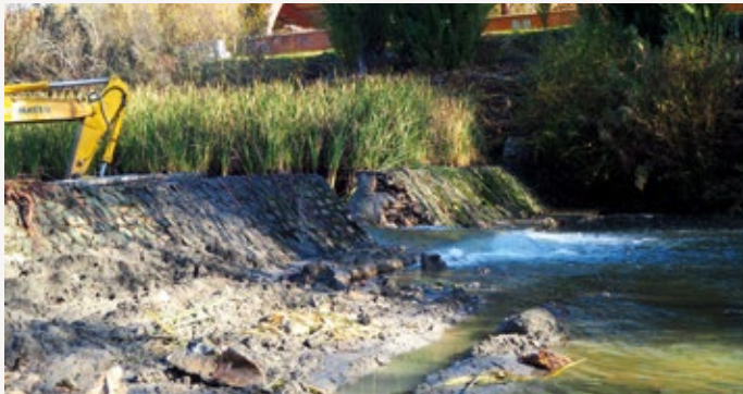
FIGURA 42 Demolición parcial del azud para vaciado del remanso y construcción de la atagüía
