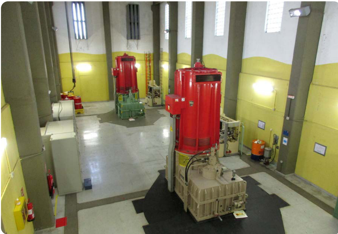
Interior de la central hidroeléctrica de Lodosa (Navarra). Autor: Silvia Cubillo Nielsen (CHE).
