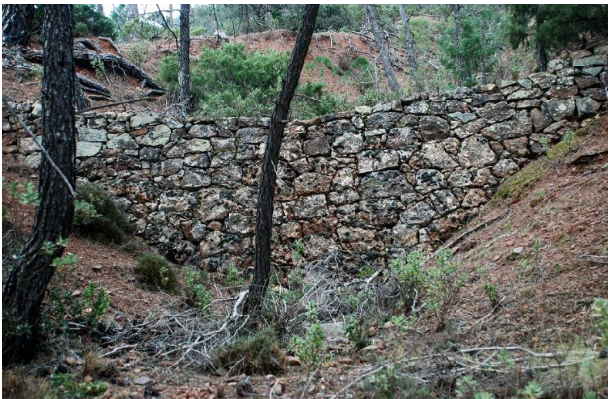
En los barrancos de Espuña es frecuente encontrar estos diques de corrección hidrológica-forestal para evitar que las lluvias torrenciales arrastren el suelo fértil de las laderas.
