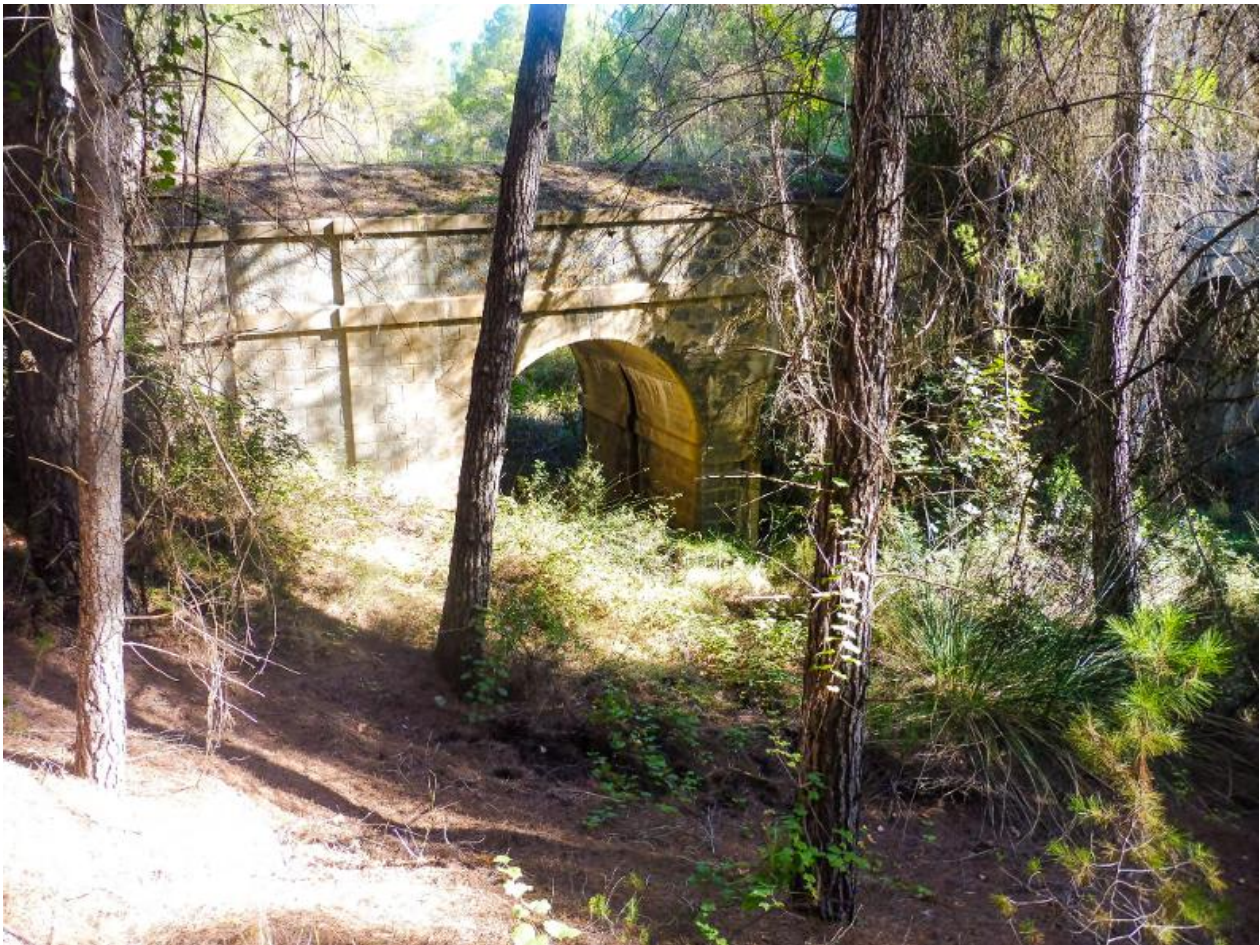
Portasifón en el sifón de Rompe Albardas, bajo la autovía RM-15 o Autovía del Noroeste.
