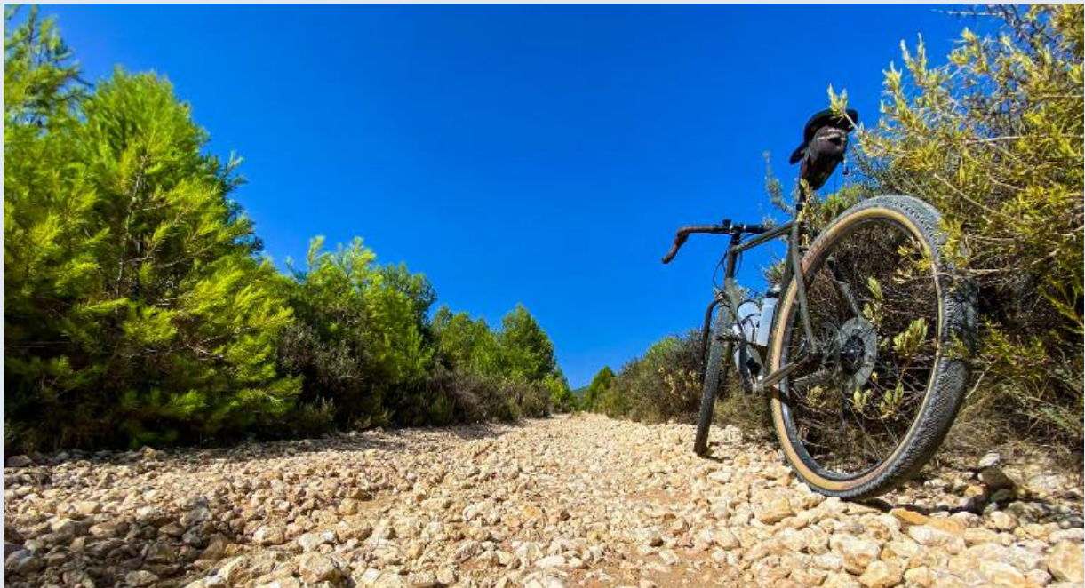
Detalle del pavimento en el camino de servicio con la grava suelta y la arena arrastrada por las lluvias.
