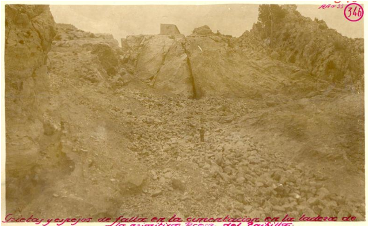
Grietas y espejos de falla aparecen en la cimentación de la primera presa del Taibilla proyectada en los años 1920. Fotografía de 1933. Fuente: archivo MCT.
