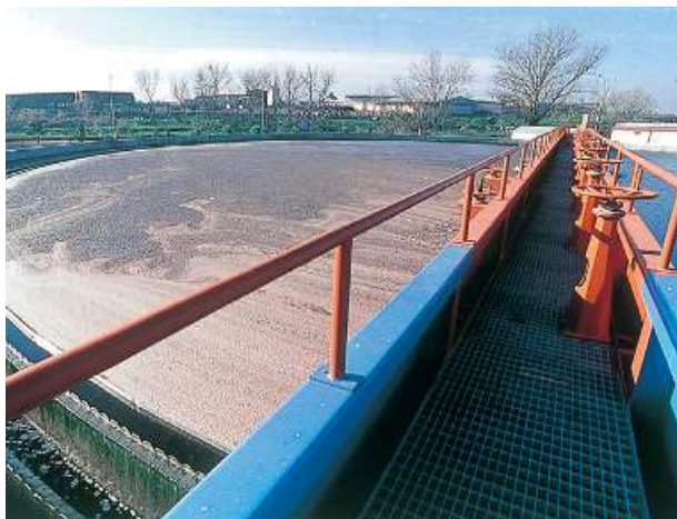
EDAR. Espesamiento de fangos
