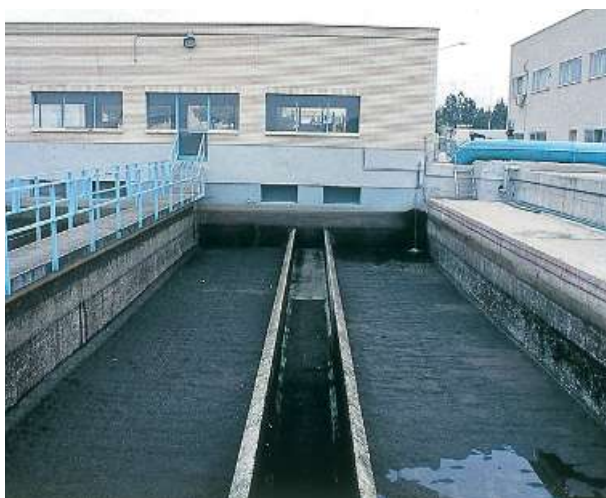
ETAP. Filtros de arena
