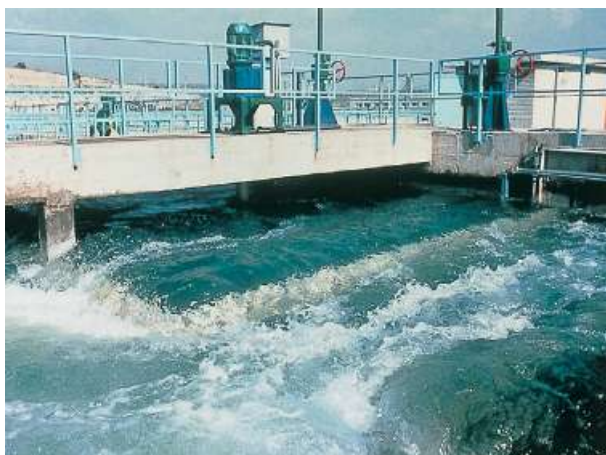
ETAP. Entrada de agua bruta
