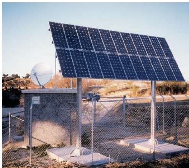
Estación de SAIH en Perales de Villamantilla
